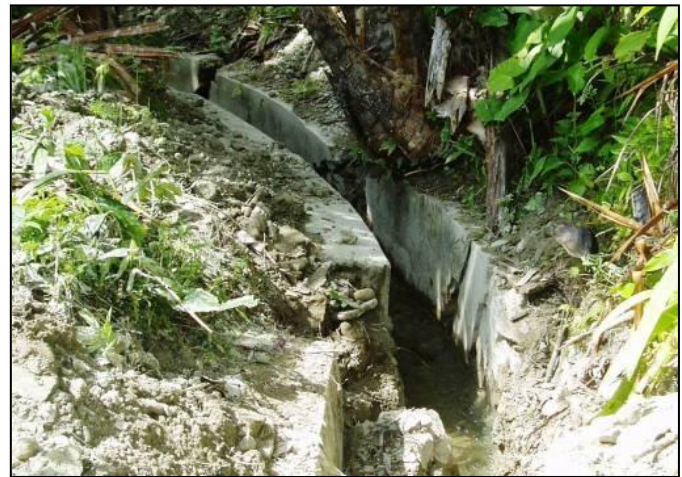
Plate 1 Earthquake damaged canal in Nias (Tremblement de terre endommagés des canals à Nias)
