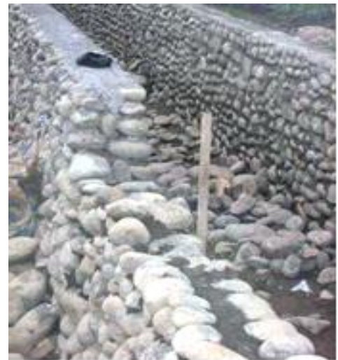
Plate 6 Typical masonry construction with rounded stones, weak mortar and left uncompleted (Maçonnerie typique avec des pierres arrondies, mortier faible et les restes inachevés)
